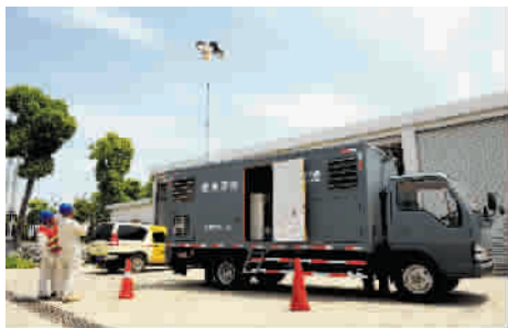
浦东公司工作人员检查发电车照明装置 李文 摄
