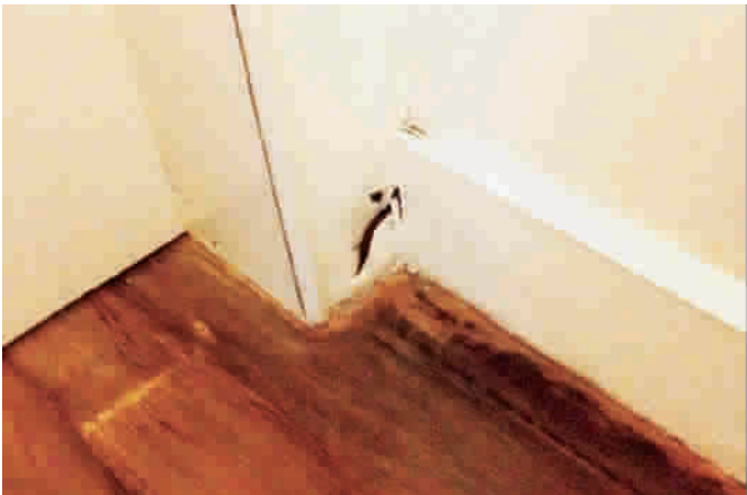
■ 渗水的墙角与地板已腐烂
