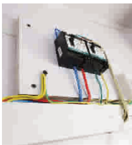
■ 许阿婆家凌乱老化的电线被重新排过,安全性大大提高
