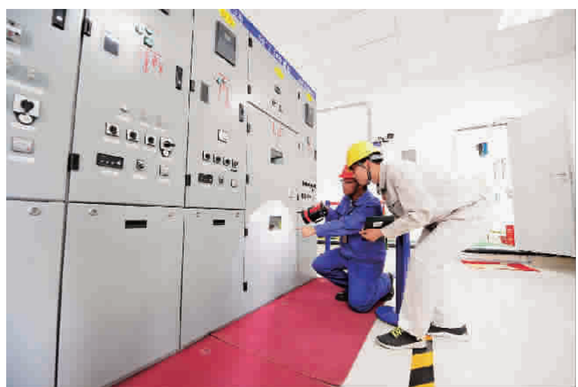
■ 工作人员在青草沙变电站巡视
