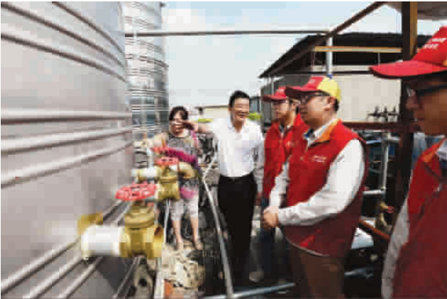
■ 电力服务队上门指导客户电锅炉的运维事项
