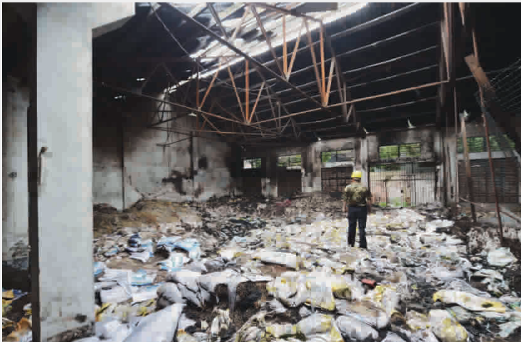
■ 莘朱路违法搭建的仓库曾发生火灾,过火面积 1000 平方米
