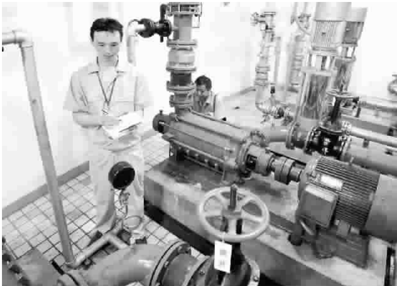
■ 物业工作人员正在检查小区的消防泵
