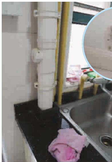
▲ 陆丰路 116 号内,楼上住户水管漏水,水流沿水管而下,流入闫女士家中
