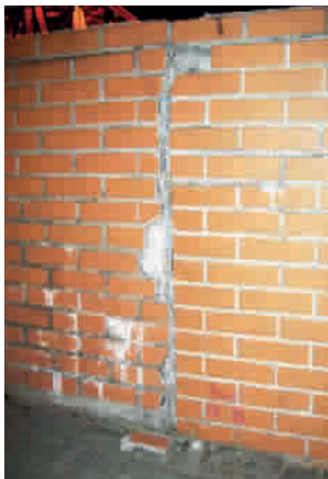
■ 防汛墙上的裂缝 房浩 摄
