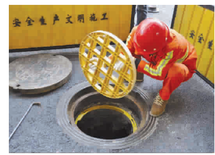
■ 无主井盖得到“托底”处置,及时消除安全隐患 本版图片 本报记者 陈梦泽 志愿者 张呈君 摄
