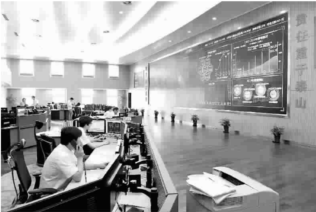
■ 浦东供电公司电网调度控制中心
