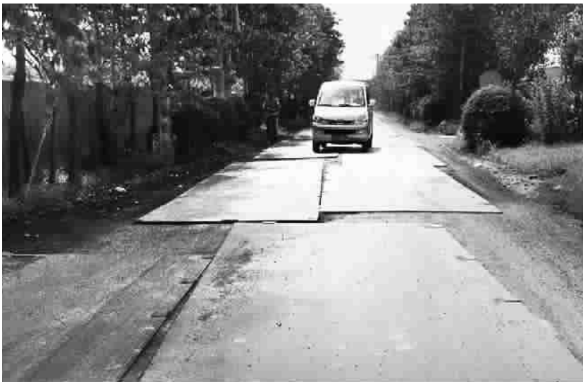
合庆镇朝阳村附近有一条一里多长的“钢板路”,雨天路滑,事故时有发生
