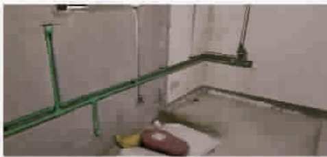
图为排线管道
