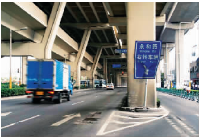
道路指示牌被撞得扭曲变形
