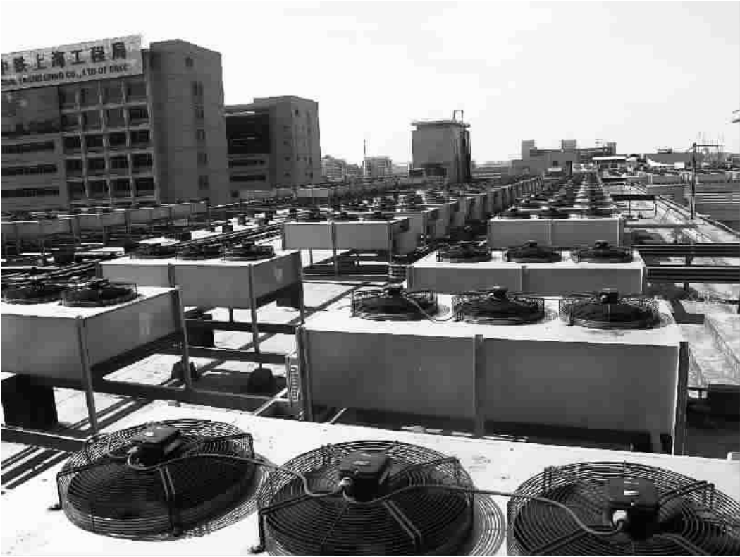
■ 楼顶空调风机密集排队，蔚为壮观
