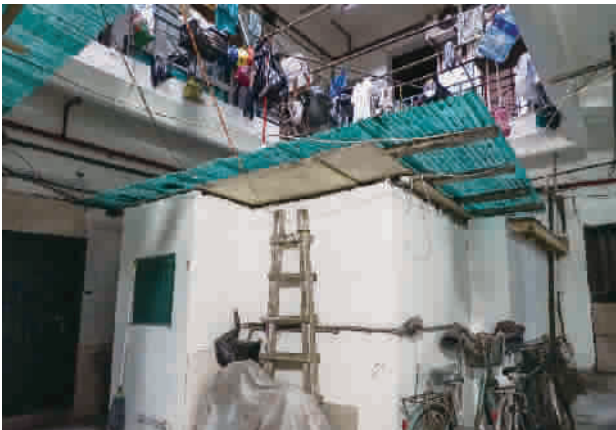
■ 楼内通道被违法建筑占据
