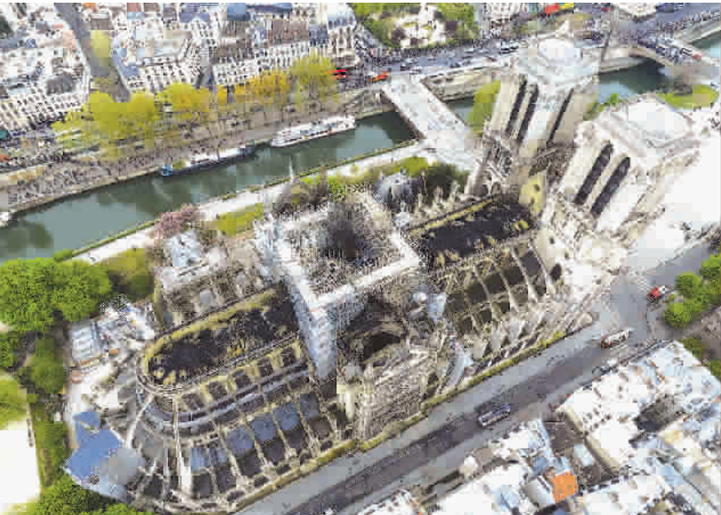
■ 灾后的巴黎圣母院屋顶损毁严重
