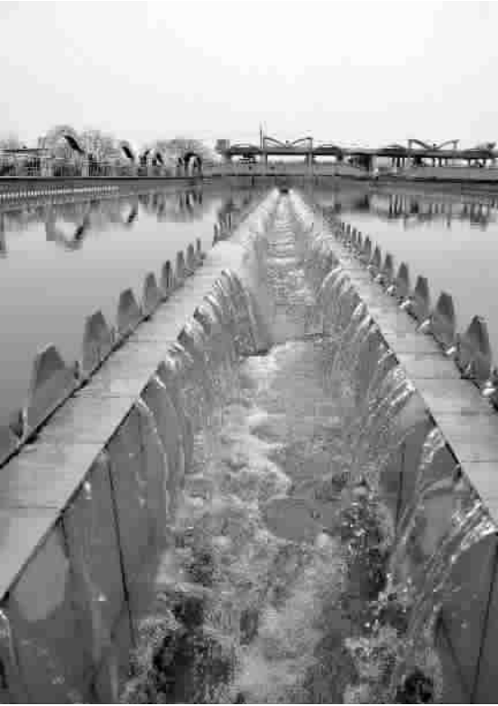
■目前,广西柳州市自来水厂已启动应急预案,针对除镉调整处理工艺,加强水质处理过程中的监测。图为昨天,柳州市柳西水厂自来水厂处理系统正在运行中 新华社记者 陆波岸 摄
