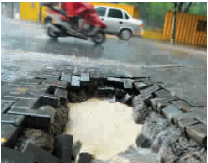
威海路近陕西北路人行道被大雨冲出一个洞
