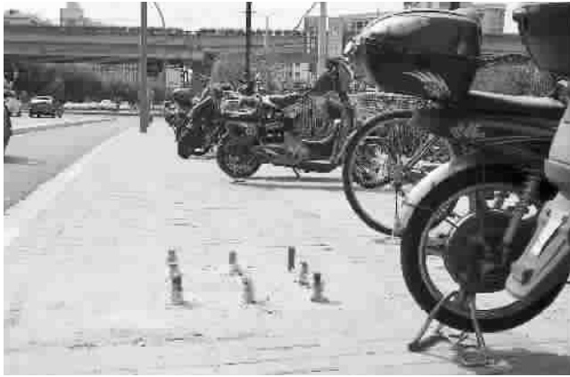
路上冒出的钢筋
