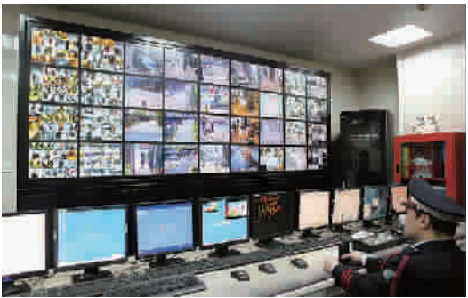
徐汇苑 2 号地下车库消控室实景图
