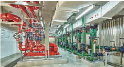
徐汇苑 3 号地下车库水泵房实景图
