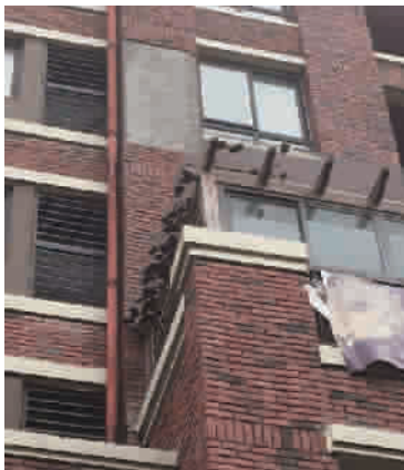
小区楼外墙面严重脱落 采访对象供图
