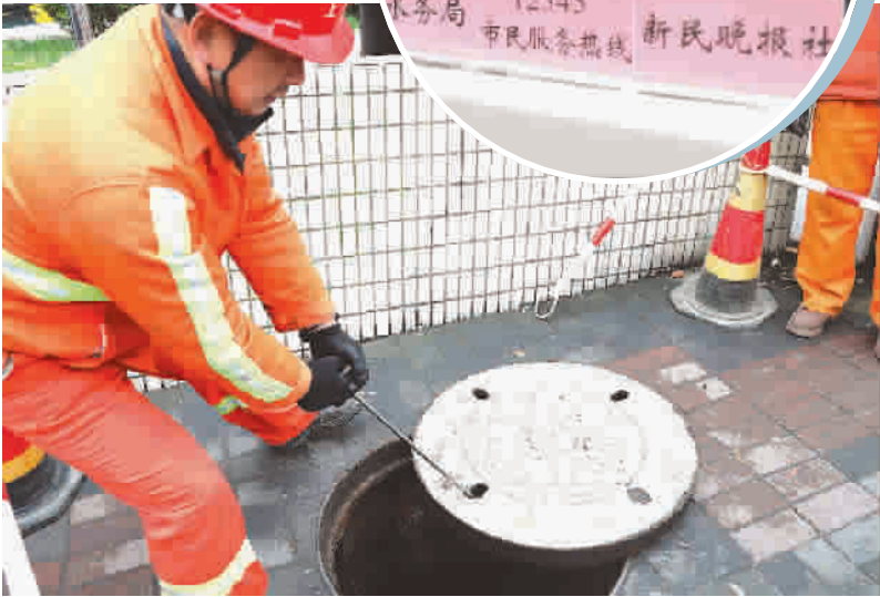
■ 上图:上海市水务局副局长刘晓涛接听热线 ■ 下图:执法人员打开雨水井进行检查 本报记者 王凯 摄
