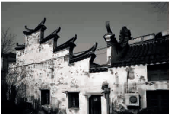
斑驳的墙面给这白墙乌瓦平添了些“人气”，让整个老屋不再沉闷，多了些“内心戏”
