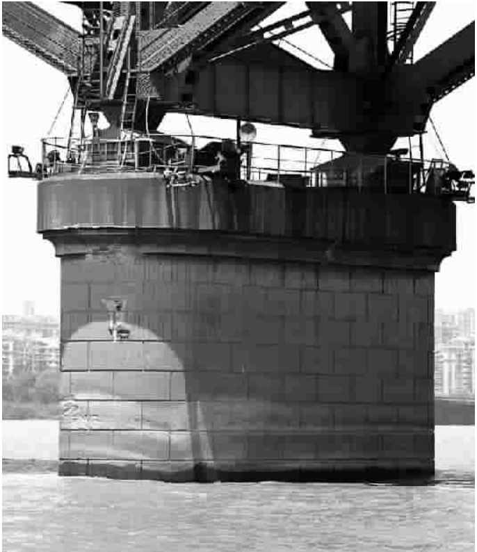
■ 南京长江大桥桥墩上被轮船碰撞留下的痕迹 新华社 发
