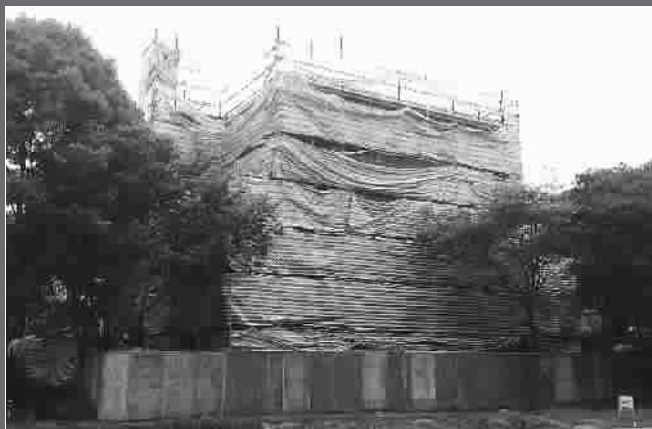
■ 祥和名邸内的违建别墅正在施工
